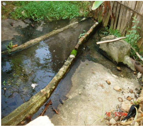
Cisterna convertida en tanque séptico, calle Emiliano Corrales.
