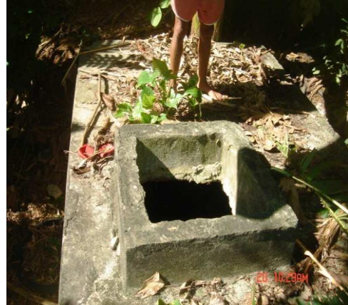
Tanque séptico edificios de Cabacú
