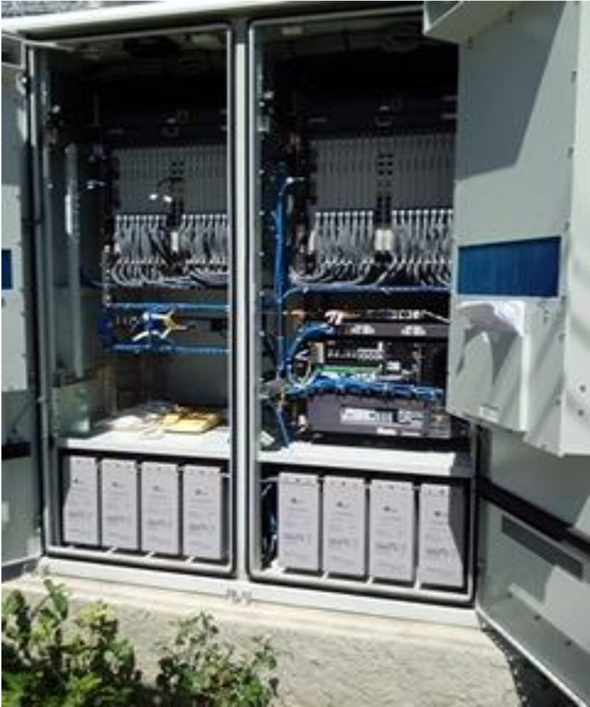
ANEXO 2 Interior del Gabinete Integral Exterior que muestra los dos sub-bastidores MA5600T.
