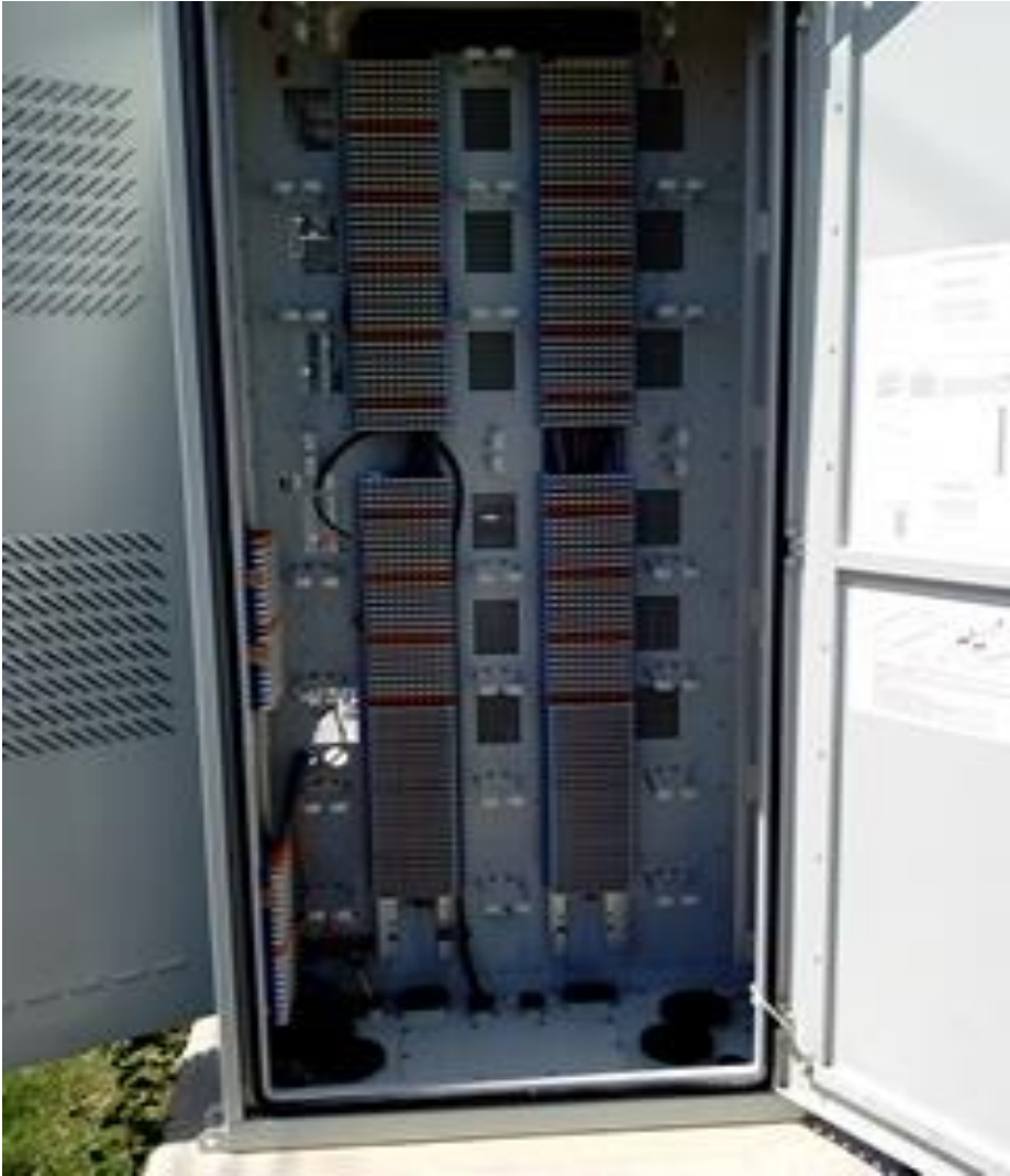
ANEXO 3 Vista lateral izquierda del (GIE) Rack de puertos de la central telefónica.
