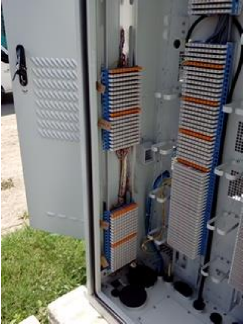
ANEXO 4 Vista lateral izquierda del (GIE) Rack cables
